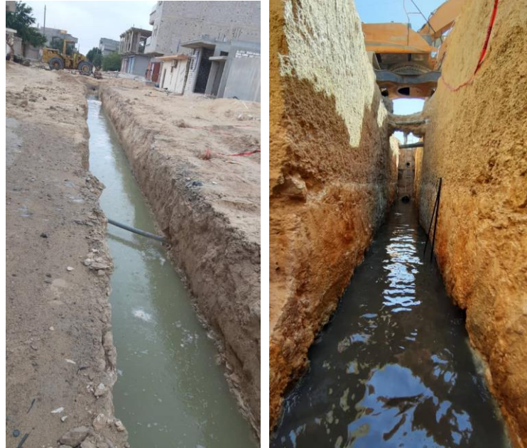
شكل 11: تسرب مياه الصرف الصحي بمدينة أجدابيا.
