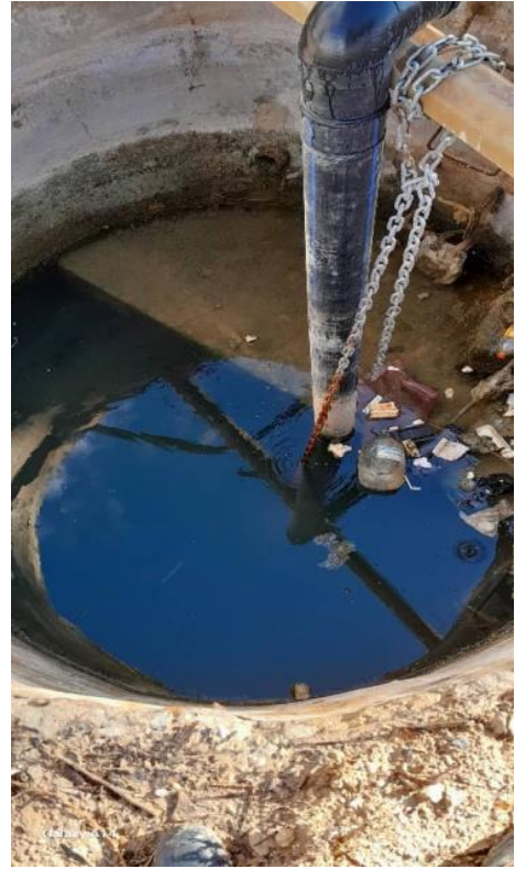
شكل 10: بئر سحب مياه الصرف الصحي ومياه الامطار سلوق ( مركز خدمات سلوق، 2024).
