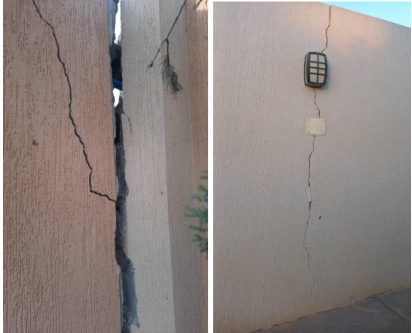
تشققات في جدران مباني في منطقة النشيع مدينة زليتن (لجنة زليتن، 2024).
