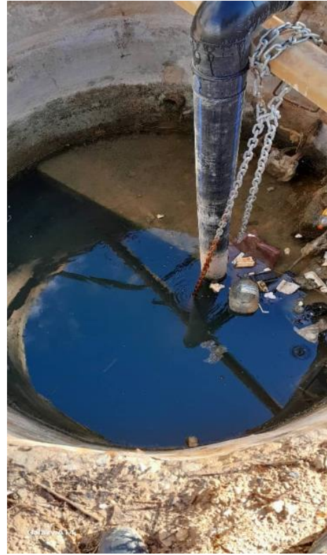
شكل 10: بئر سحب مياه الصرف الصحي ومياه الامطار سلوق ( مركز خدمات سلوق، 2024).
