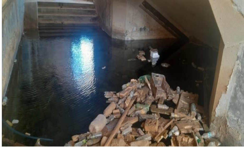
نفق في الطريق الرئيسي بالمياه الجوفية بمدينة أجدابيا. شكل 17: غمر الأقبية والإنفاق والأدوار السفلية (البادروم) بالمياه الجوفية.
