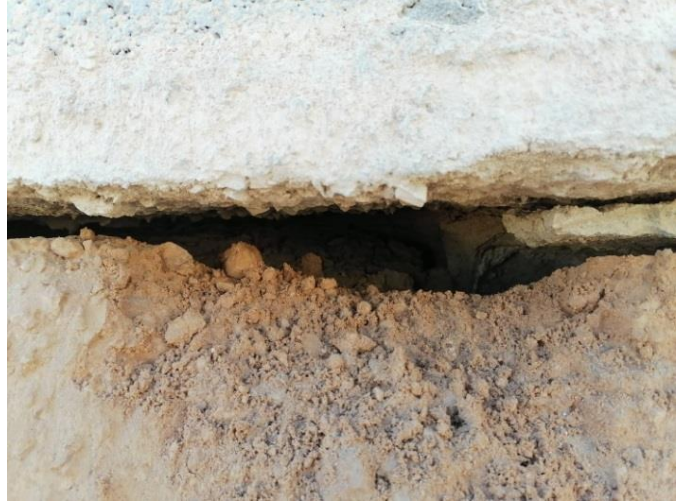
هبوط أرضي تحت منزل بمدينة أجدابيا شكل 22: الهبوطات في أرضيات المباني
